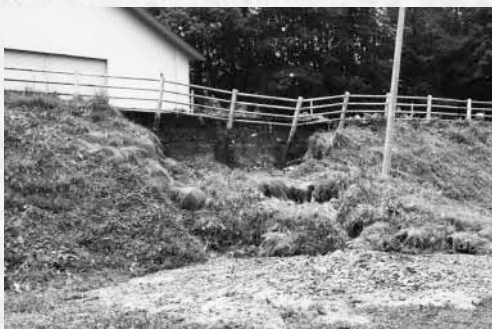
大雨により崩れた法面
