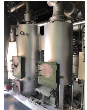
(株)匠工芸のバイオマスボイラー
